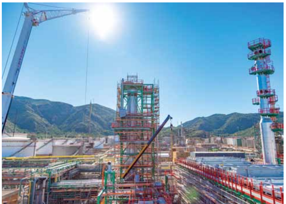
Planta de biocombustibles avanzados de Repsol en Cartagena.
